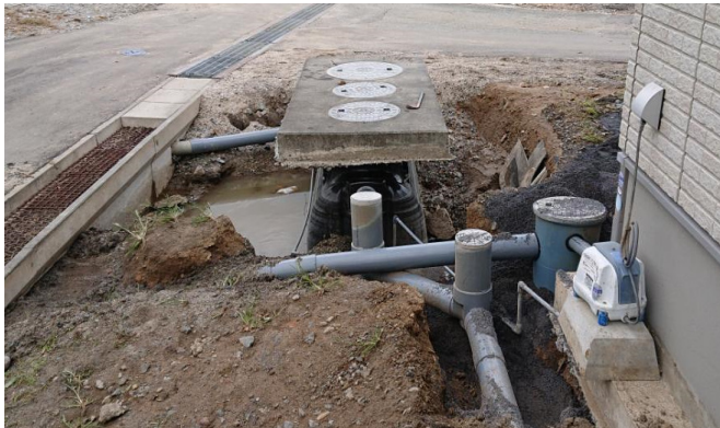
写真—1 浄化槽周辺の洗掘
