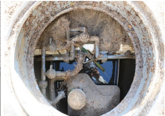
写真—2 槽内土砂流入
