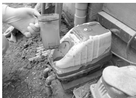
浸水したブロウ（外側カバーを外した状態、金山町西谷地区）
