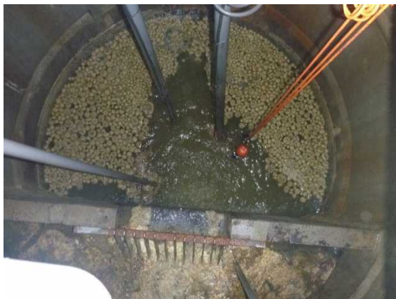
写真-10 ポンプ槽に油脂類の流入 （対策：入居者に使用上の注意）
