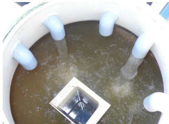
写真-9 ポンプ槽から直接配管 (⑥のパターン)
