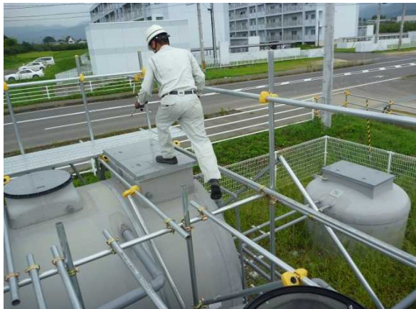
写真－４ 仮設住宅浄化槽 (維持管理の容易性・安全対策不十分)
