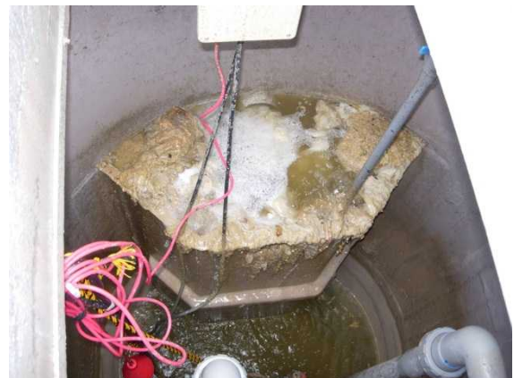
写真-11 スクリーン部の閉塞 （対策：定期的に清掃を実施）
