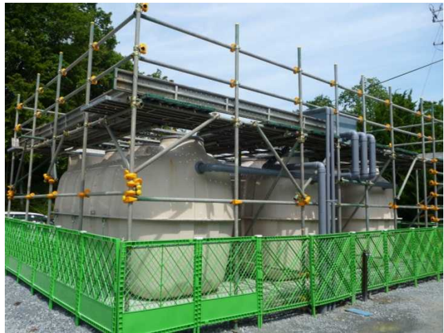
写真-2 地上設置型の仮設住宅浄化槽
