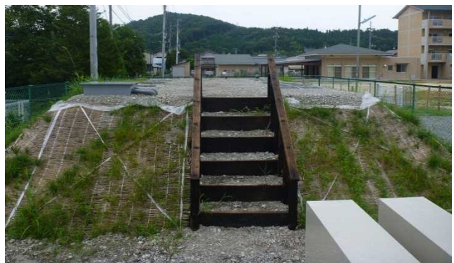
写真-3 半地下埋設型の仮設住宅浄化槽
