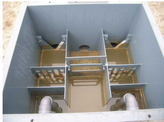
写真-7 分配槽・流量調整機能「有」(②パターン)
