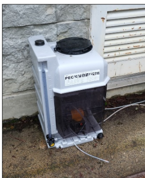
写真－４ 薬注ユニット
