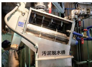
写真－２ 汚泥脱水機
