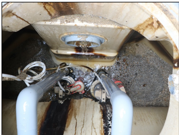
放流ポンプ槽の破損
