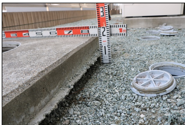
浄化槽周囲の地盤沈下
