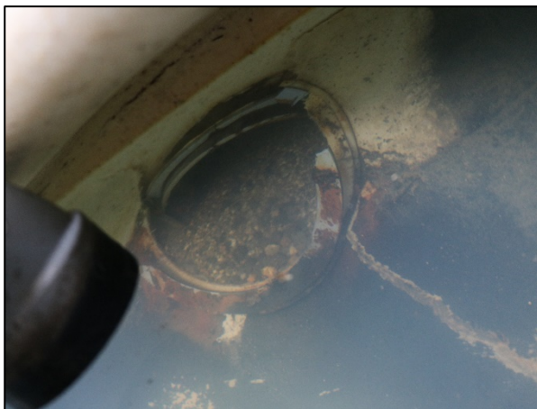
導入部の破損
